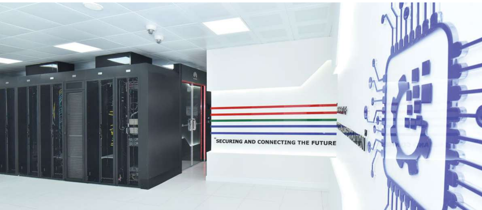
KNPC Data Center
