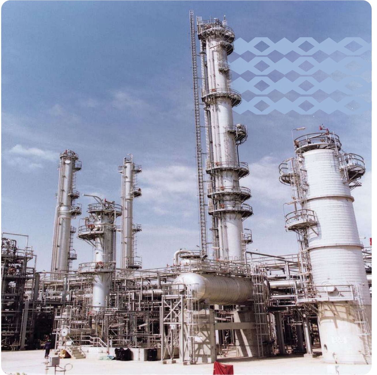
وحدة إنتاج وقود الطائرات في مصفاة ميناء الأحمدى
